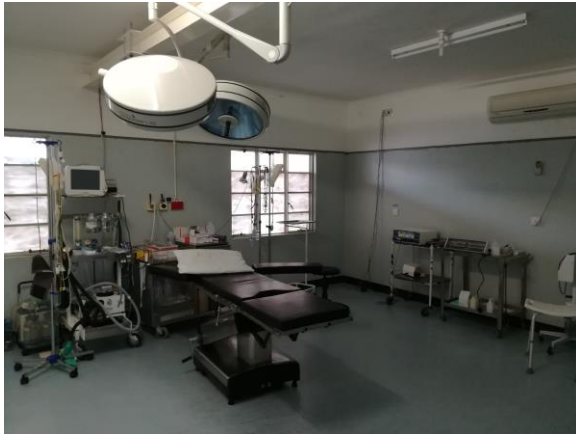
Le nuove luci lampade chirurgiche della sala operatoria con nuovo impianto di condizionamento
