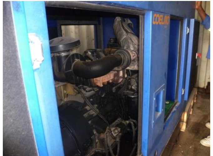
particolare del generatore
