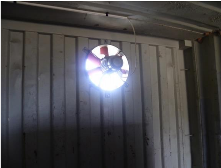
Sistema di ventilazione
