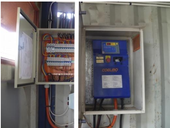
Quadro di controllo generatore
